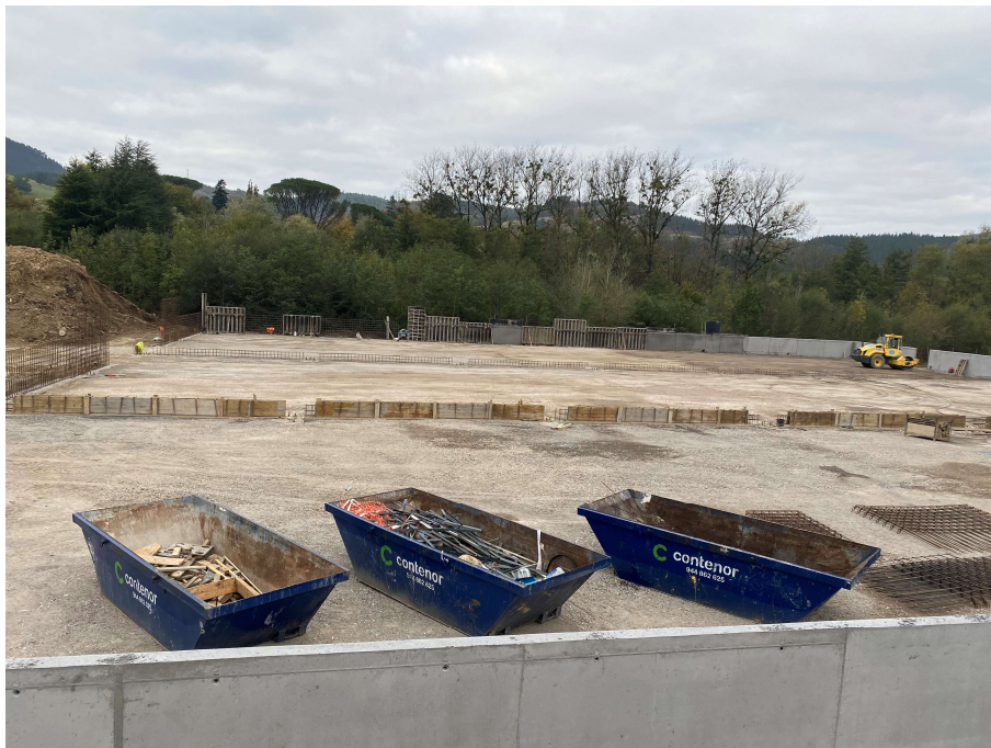
Contenedores de recogida selectiva de residuos
